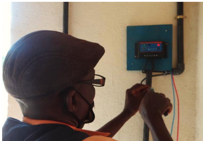
Elektrotechniker SImplice von MicroSow beim anschließen des Solarladereglers
